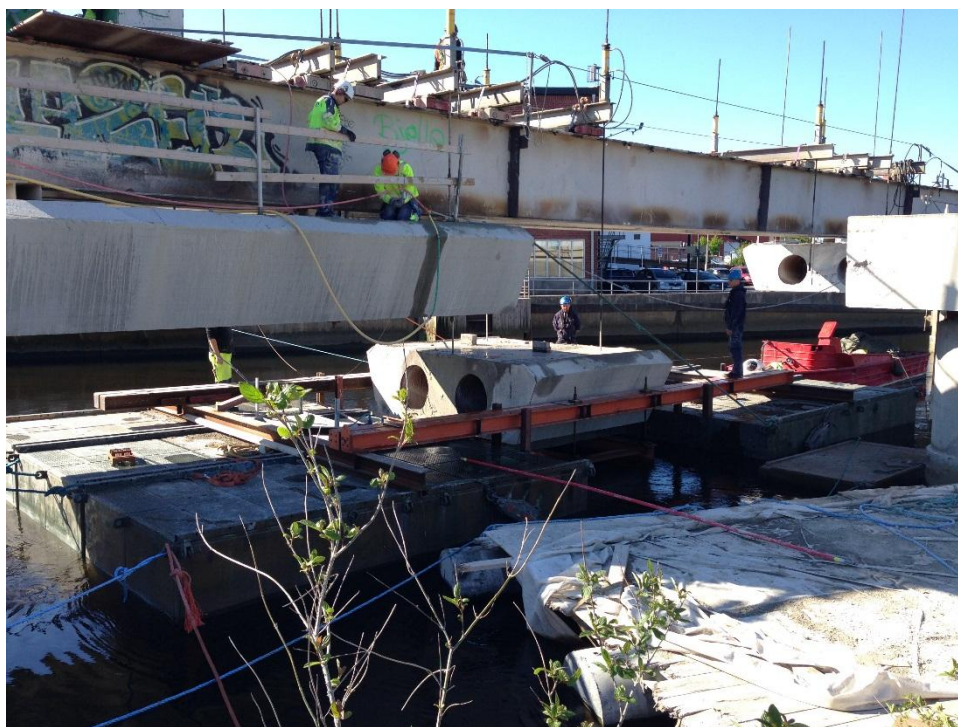
Figur 5 Nedmontering av betongbro. Den fastmonterade stålbron syns som en balk längst upp i bild, del av betongbron som precis har sänkts ner till pråmen syns i mitten av bilden och i förgrunden anas den pråm på vilken betongslammet samlas upp.
