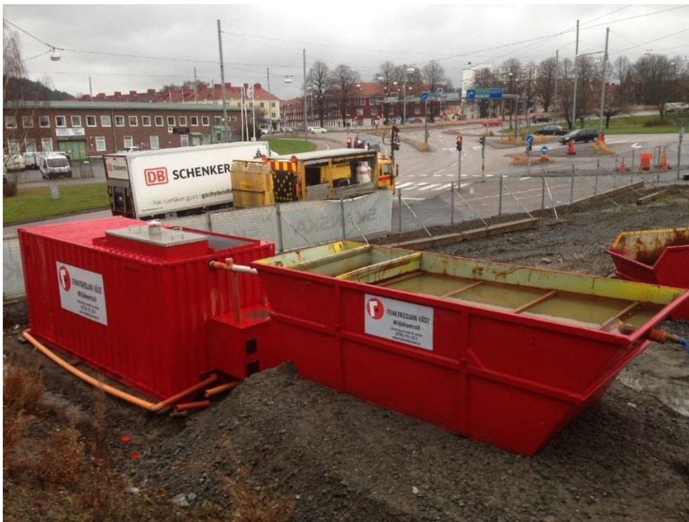
Figur 21. Till höger fackcontainer och till vänster en oljeavskiljare med filter.
