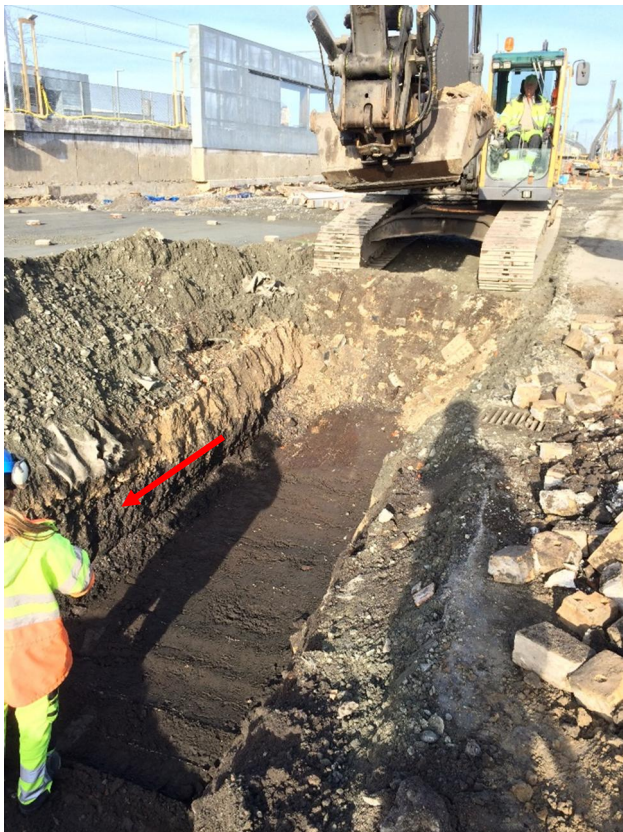
Figur 18. Del av VA-schakten i söder om Sävån (yta 4:1 VA). I schaktväggen under tegelytan (orange i bild) finns kvarvarande massor med höga/mycket höga PAH-halter (röd pil).
