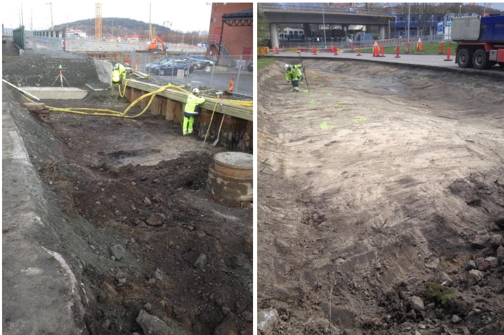
Figur 16. Till vänster schaktbotten vid yta 4:2 där kompletterande schaktbottenprovtagning utfördes efter okulär kontroll och till höger schaktbotten vid yta 4:11 där endast okulär kontroll utfördes.
