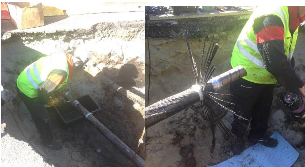
Figur 7. Till vänster en bild från kapning av oljefyllt kabel. När kabeln kapas samlas oljan upp i träget under. Till höger en bild när kabeln kapats. Båda ändarna hålls uppe så att det inte ska rinna ut mer olja under tiden som kabeländarna försluts/lödas igen.
