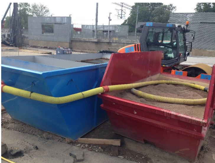
Figur 20. Till vänster fackcontainer och till höger sandfiltercontainer. Notera att vattnet rinner över till sandfiltret sprids ut över ytan med hjälp av dräneringsslang i syfte att inte skapa kanaler i sanden.
